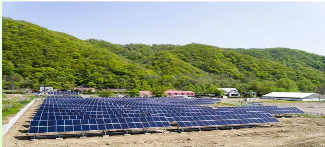
農地に直接太陽光パネルを設置している例(奈良県)
